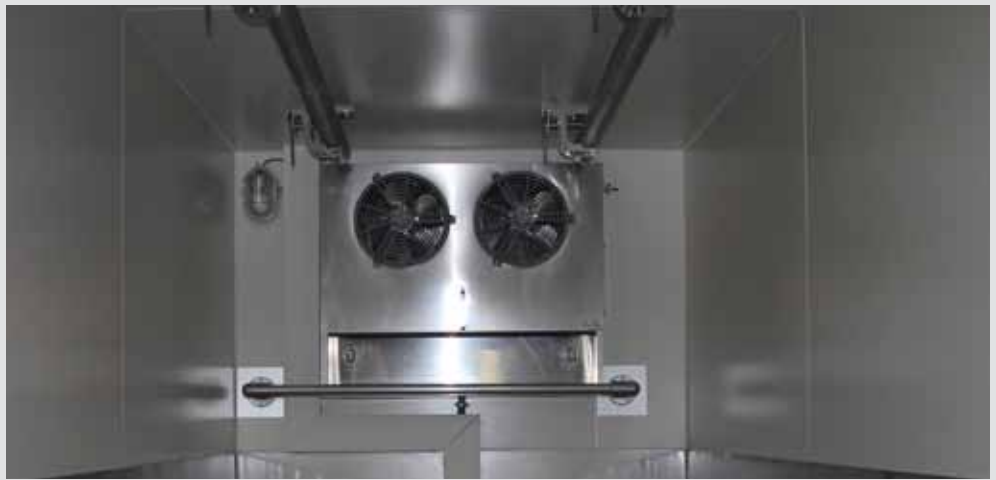
Flachverdampfer und Dachrohrbahn
