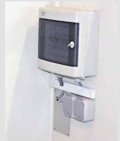
Sicherungskasten mit Steckdose
